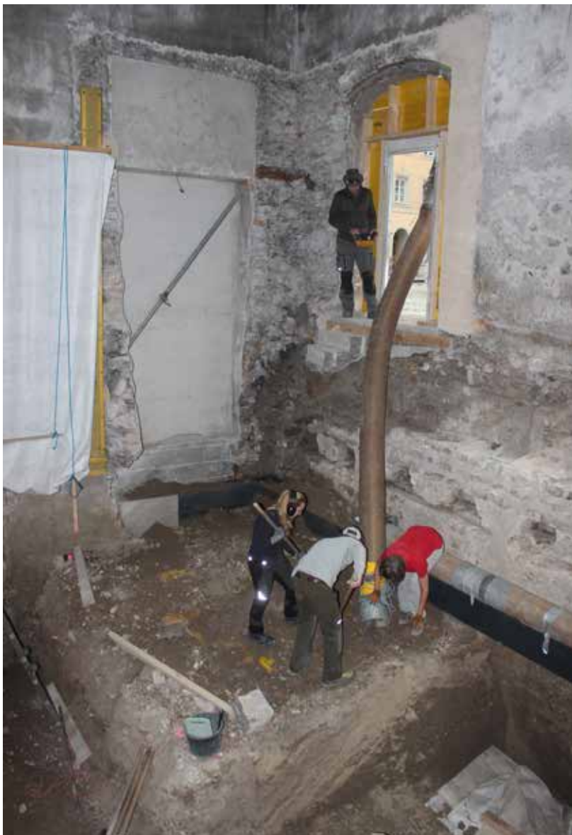
Abb. 1: Schneiderkapelle, Hall i. T., April 2022, Nordwestecke, Entnahme des archäologischen Aushubs mittels Saugbaggers, rechts unter den Balkenlöchern eine zur Sicherung der hangseitigen Mauer eingezogene Stahltraverse.
